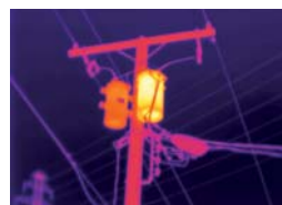
Transformadores eléctricos sobrecalentados
