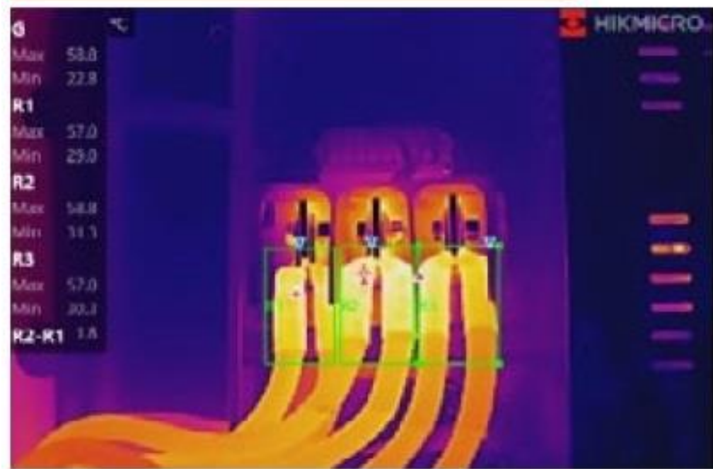
Inspección eléctrica Aconsejado uso de sensor desde 320x240
