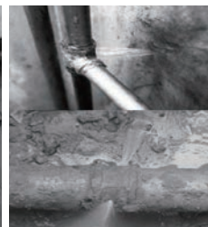
Sistema de rociadores contra incendios
